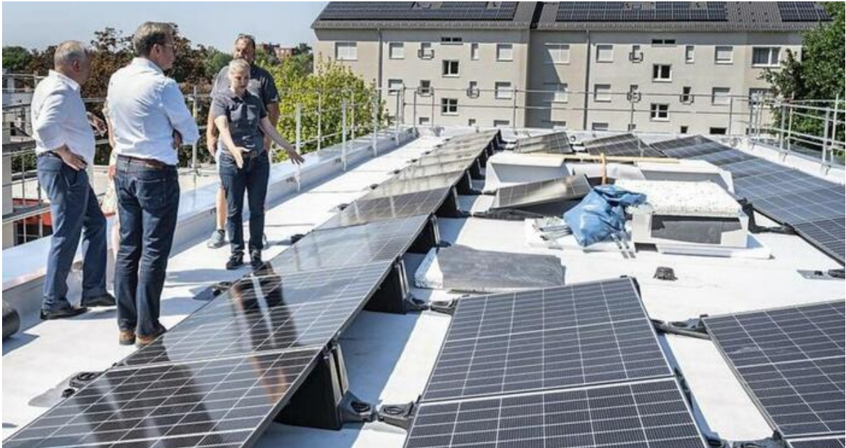
Der Solargenerator versorgt etwa Küchengeräte und elektronische Tafeln mit Strom und dämmt auch die Hitze im Sommer ein. In einem Jahr soll eine Batterie mit passender Speicherkapazität hinzukommen. © Marc Strohfeldt
